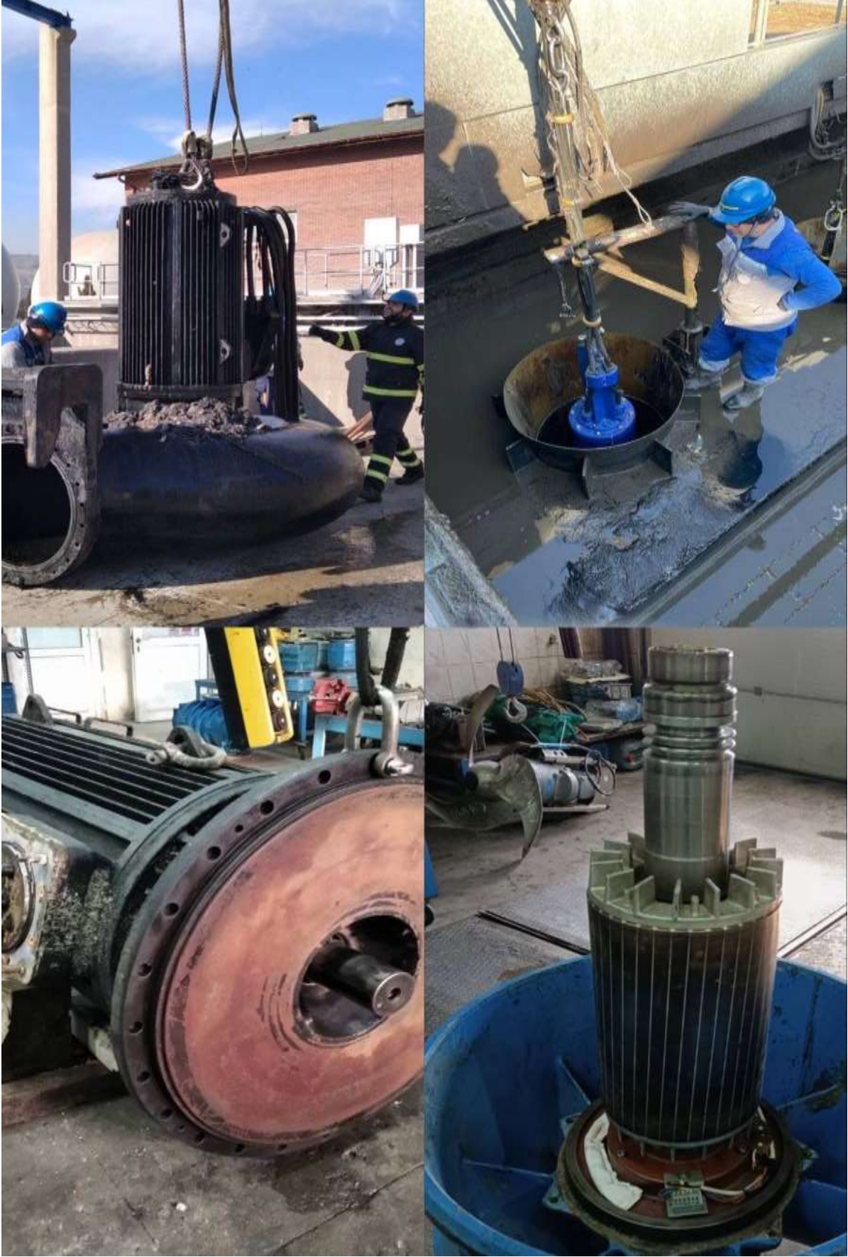
Giriş ve Geri Devir Pompa Bakımları
